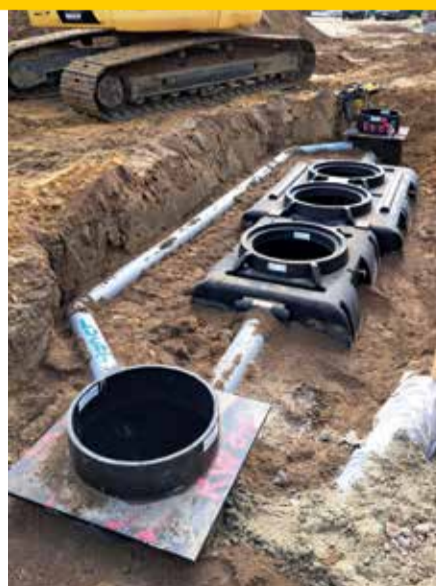
Stroomopwaarts van de infiltratievoorziening zorgt een olie- en benzineafscheider voor de voorzuivering van het oppervlaktewater.
