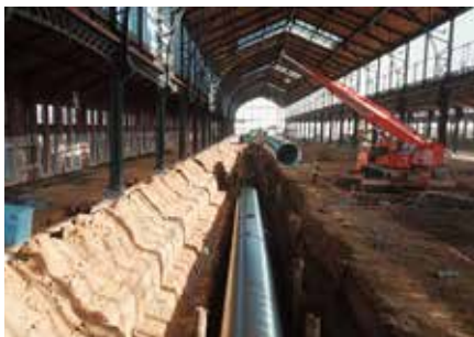
De plaatsing van de 440 lm Tubao-tanks nam slechts vier werkdagen in beslag.
