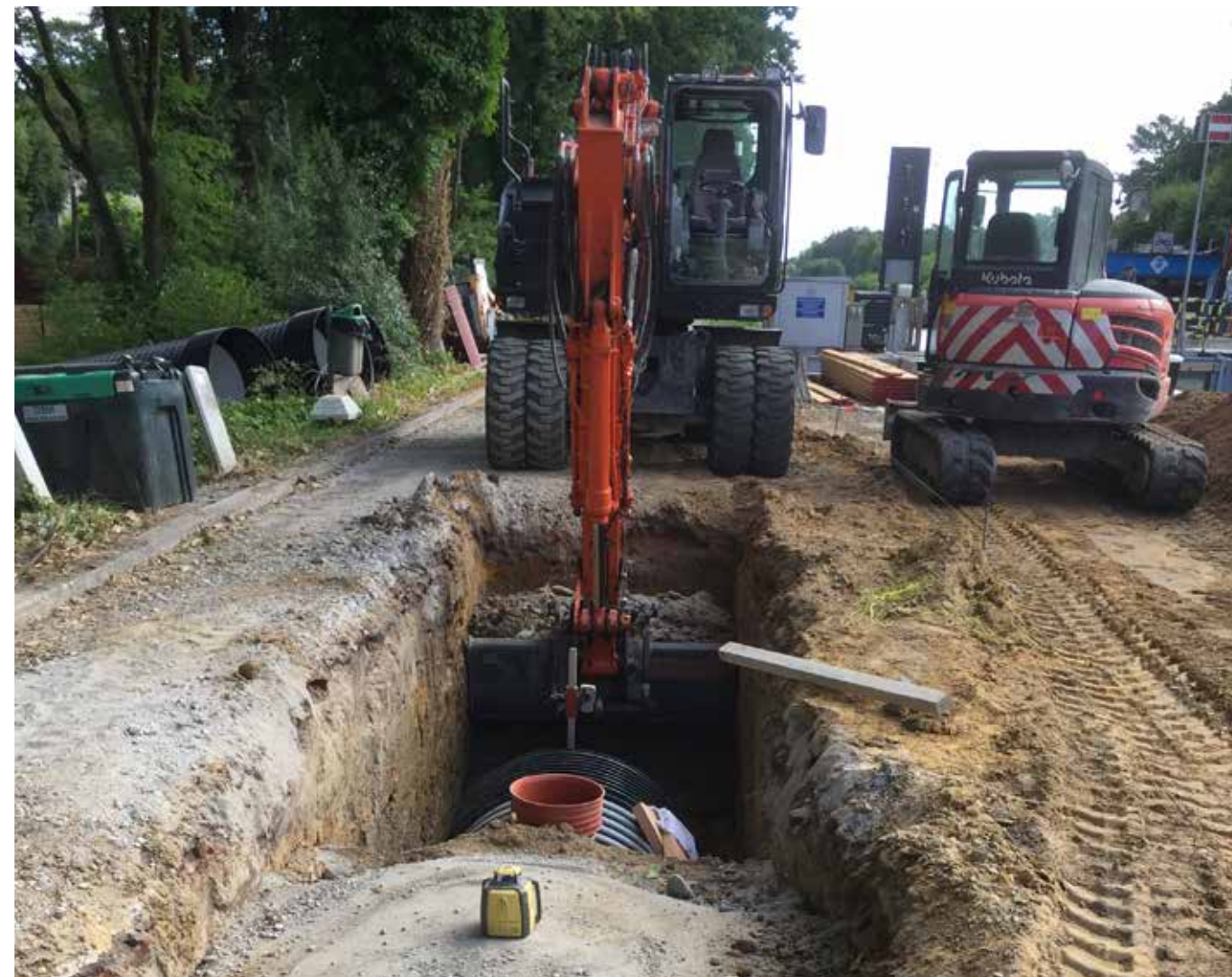
Er werd gekozen voor de aanleg van een omloopriool, ook wel tapduiker genoemd.
