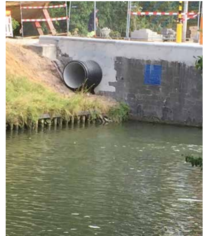
Voor een cruciaal deel van dit project viel de keuze op Deschacht als leverancier van grote Ribwall buizen uit polypropyleen.
