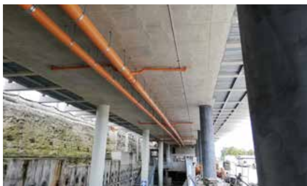
De afvoerleidingen met hoge vullingsgraad werden vervangen door PP-buizen en ook om het regenwater van de overkapping af te voeren werden PP-buizen gebruikt."
