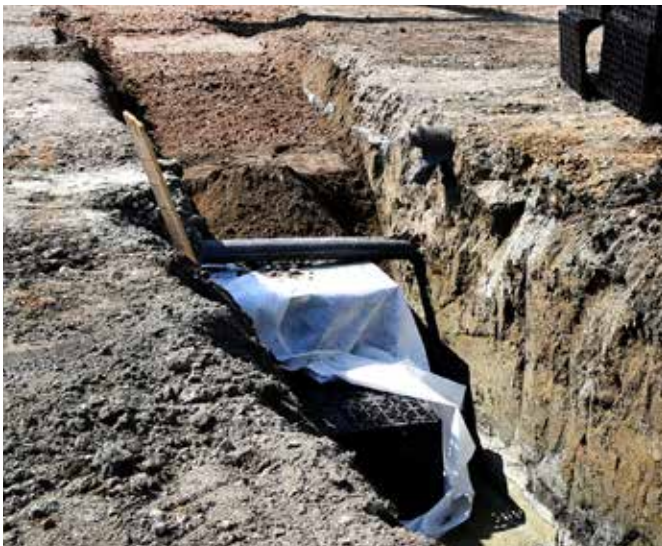
Het bekken laat het regenwater van een totale oppervlakte van 14.000 m 2 in de bodem infiltreren.
