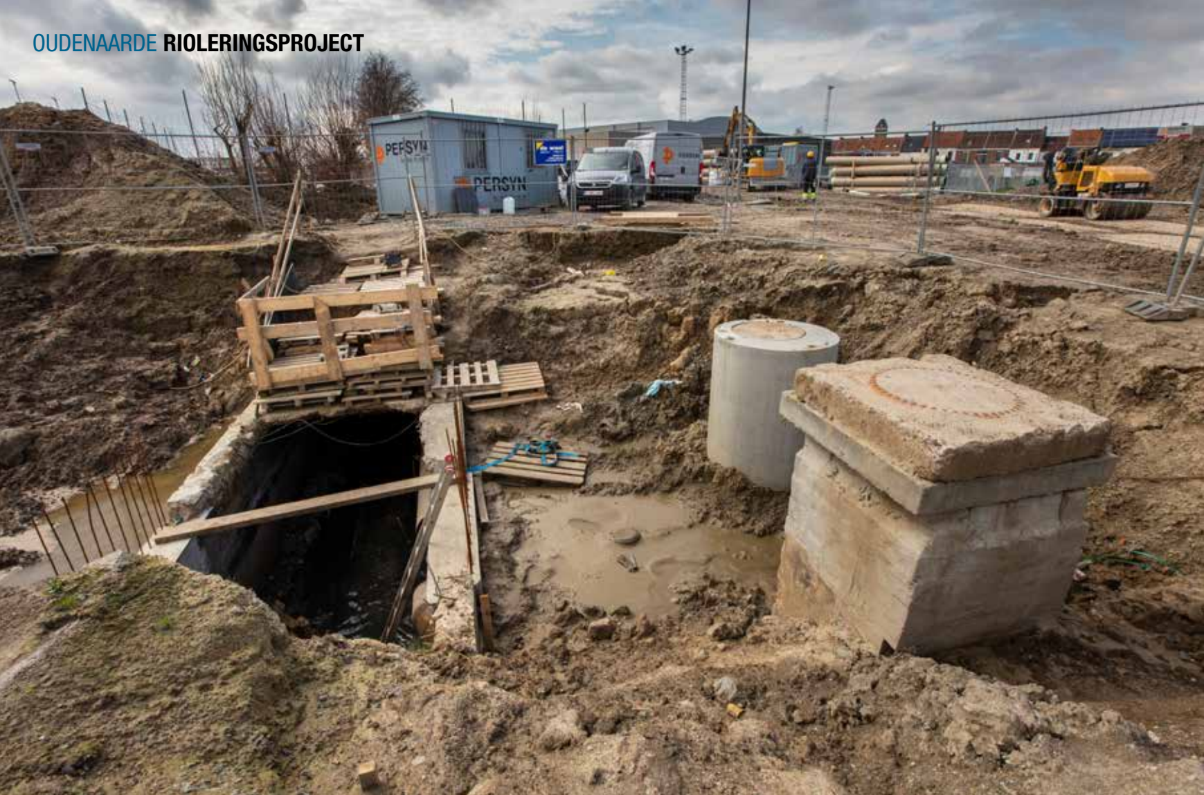
In de Rietgracht in Oudenaarde zorgt aannemer Persyn in opdracht van Aquafin voor een scheiding van afval- en regenwater.
